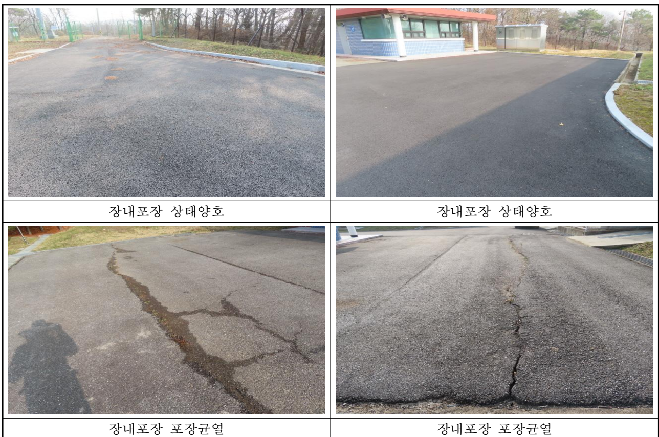
【사진 3.10】 도로포장 손상사진
