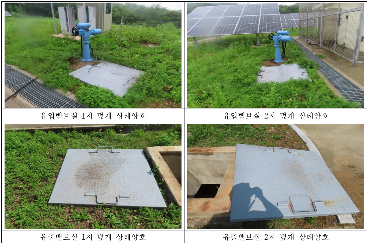
【사진 3.11】 환기구 등의 덮개 손상사진
