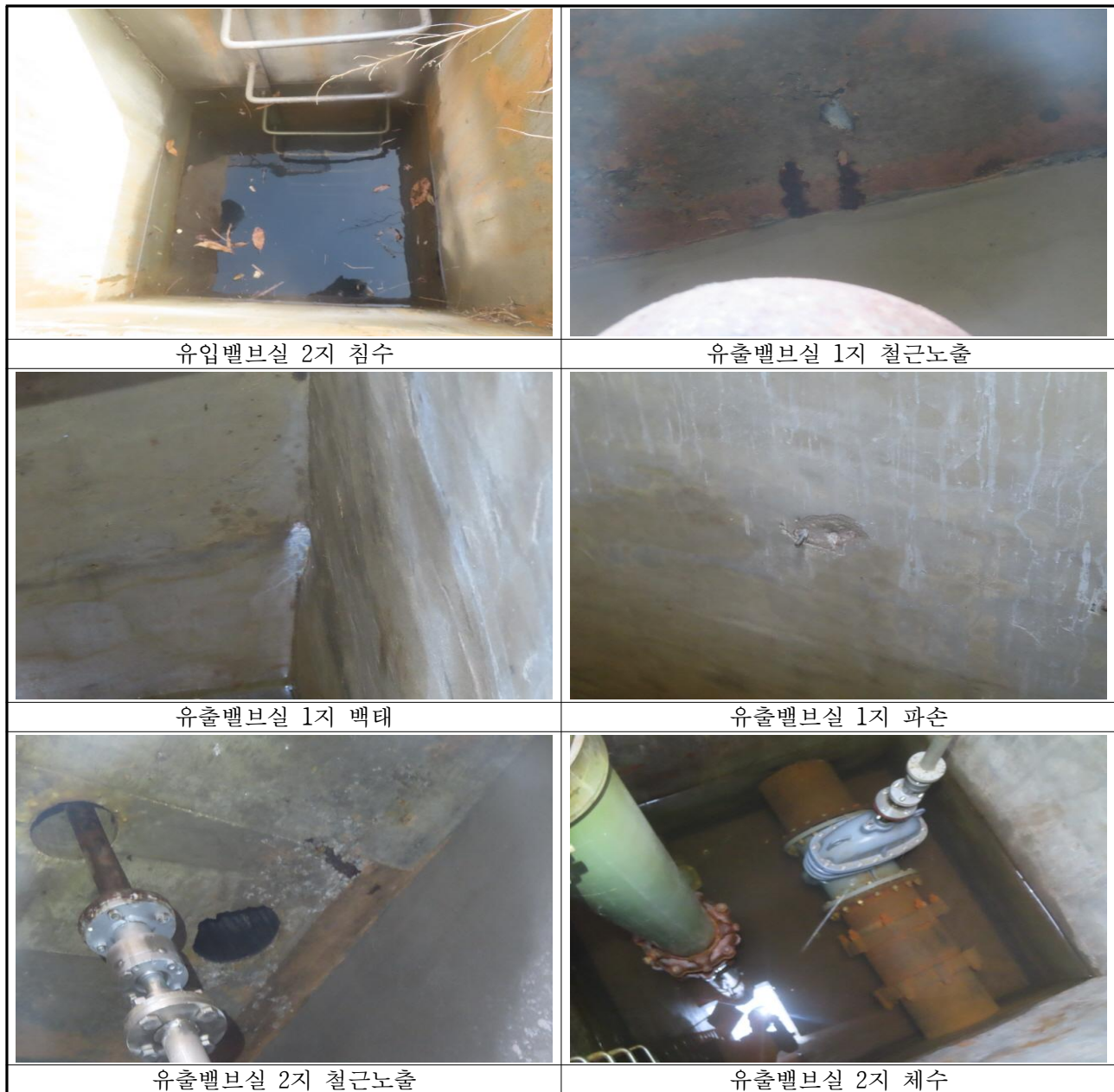
【사진 3.4】 유입·유출 밸브실 손상사진
